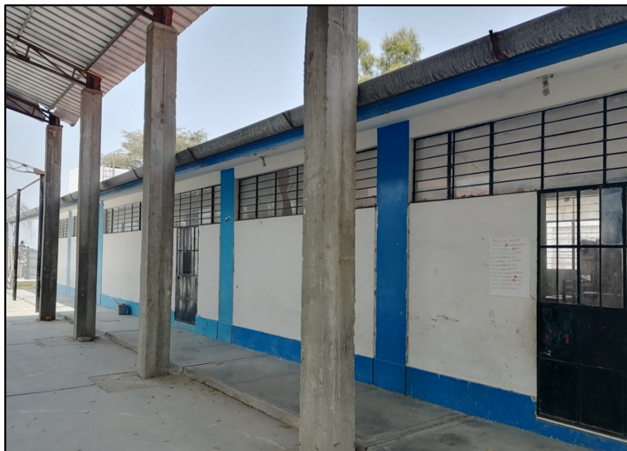
Foto N° 4: PERSPECTIVA DEL BLOQUE 05 EN ESTADO REGULAR EN SU ESTRUCTURA.
